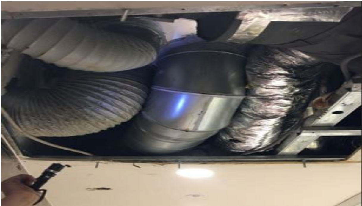
Afzuigkanaal met inspectieluik
