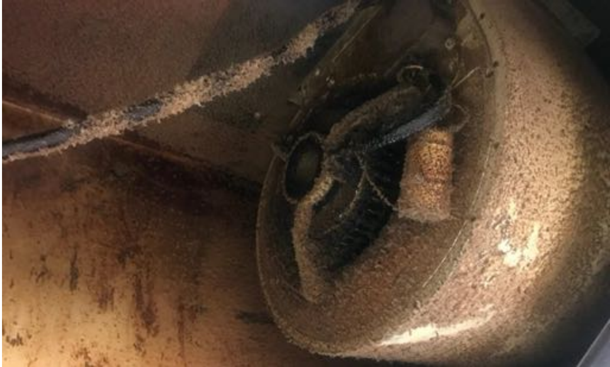
Sterk vervuilde motor van afzuiginstallatie
