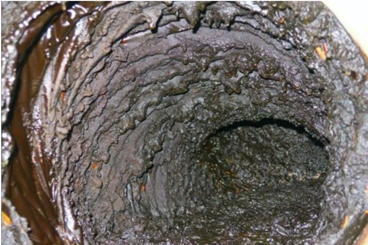
Vervuild vetafzuigkanaal (extreem vuil door gebruik houtskoolgrill)
