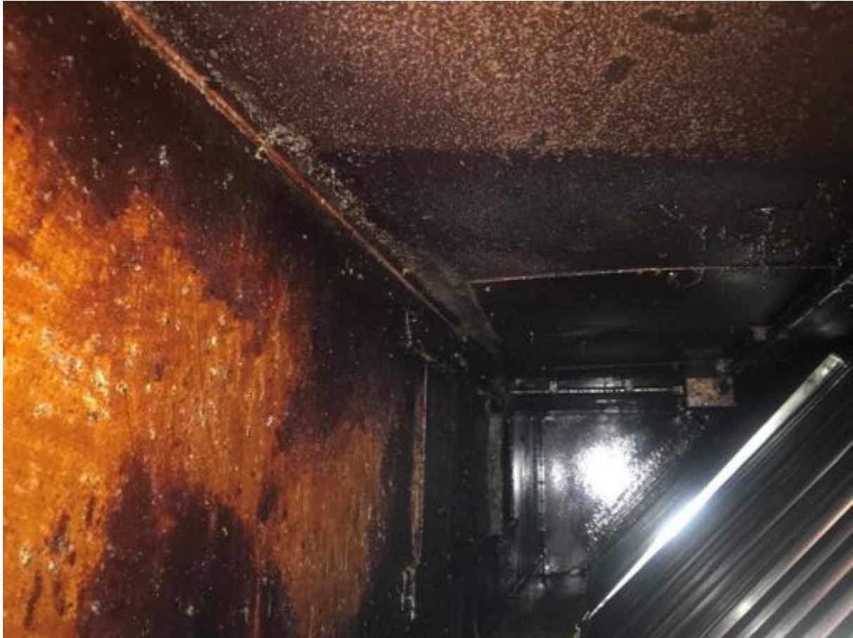
Vervuild afzuigkanaal direct achter de (schone) roosters
