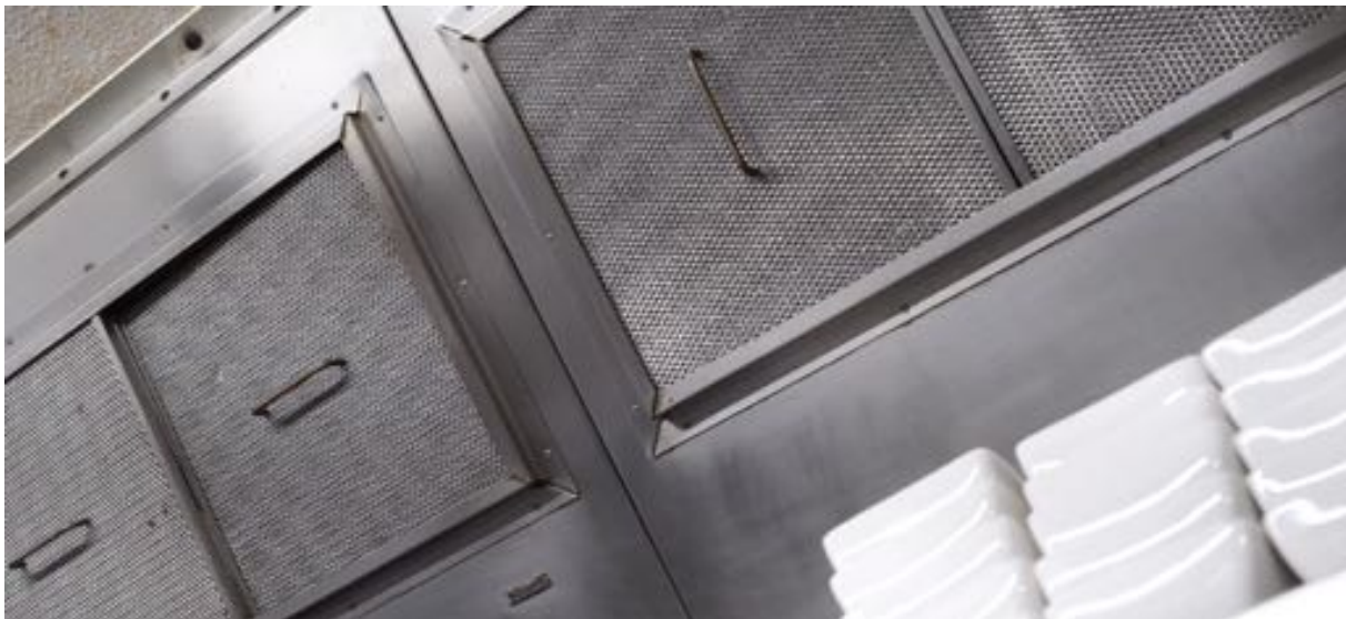
Visuele inspectie afzuigkap
